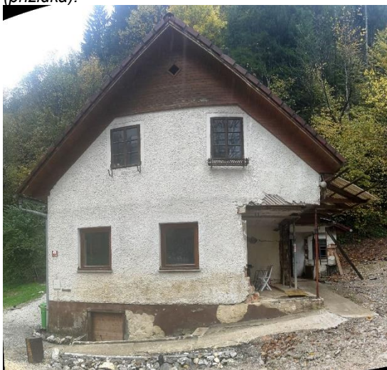
Fotografija 3: Pogled na Z fasado objekta. Viden je manjkajoči vogal.
