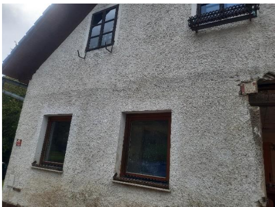
Fotografija 1: Pogled na J fasado objekta. Viden je manjkajoči vogal ter poškodovane stene vhoda (prizidka).
