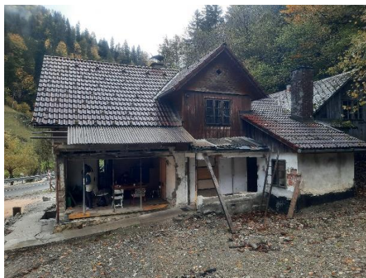
Fotografija 2: Pogled na J fasado objekta. Viden je manjkajoči vogal ter poškodovane stene vhoda (prizidka).
